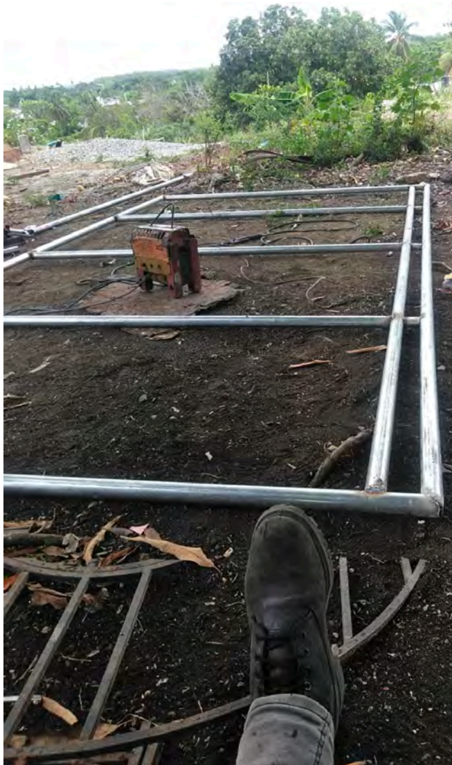
Construcción de una puerta para el cerco perimetral Construction of a gate for the perimeter fence
